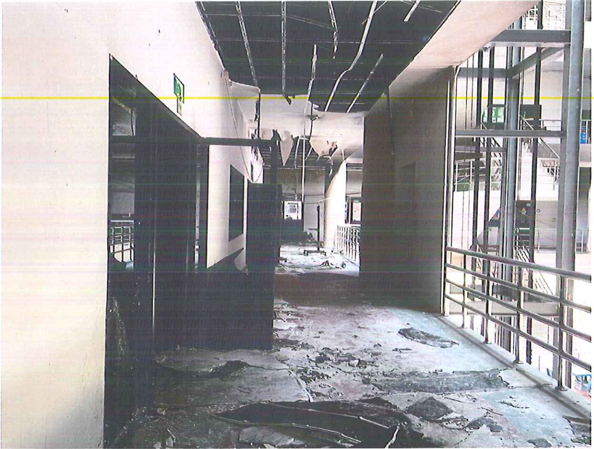
ภาพฝ้าเพดาน ที่ได้รับความเสียหาย
